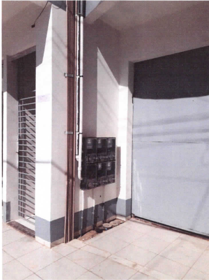
Figura 15: Entrada garagem e Medidores de Energia
