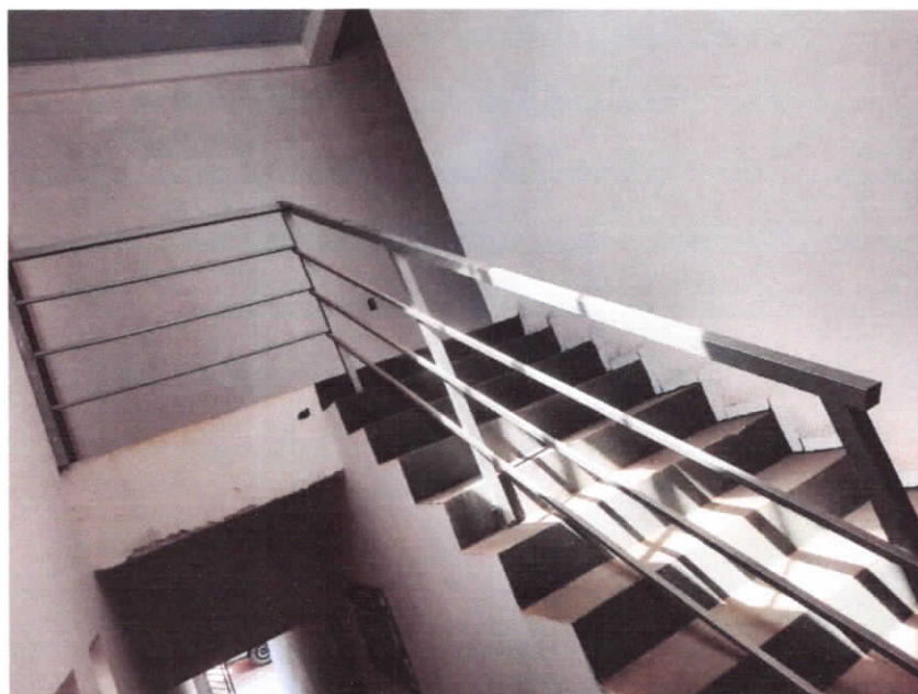
Figura 8: Escada e Corrimão, Laje com escoriações.
